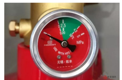
図 3 圧力不足を示す圧力計
